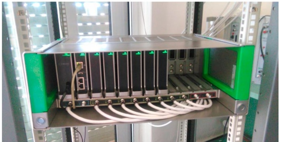
Το Ikusiflow στον χώρο δοκιμής.
